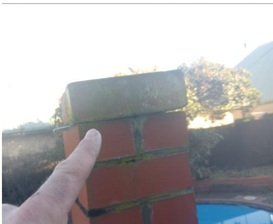
Column cap loose
