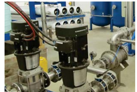
Skid de osmosis inversa para desalinización de agua de mar con membranas LG de alta eficiencia y bombas CR Grundfos.
