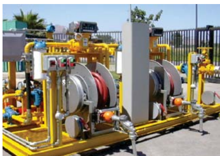
Plataforma para despacho de combustible con bomba, flujómetro, carrete para mangueras, pistola, acoples, etc.
