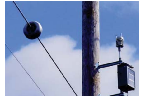
Sistema de medición inalámbrica PowerDonut, de variables en líneas de transmisión eléctrica AT/MT y estación meteorológica.
