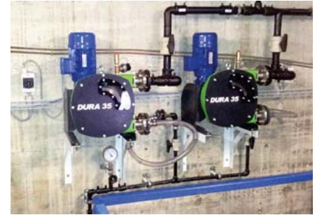
Sistema redundante de dosificación para ablandamiento de agua con bombas peristálticas Verderflex automatizado.
