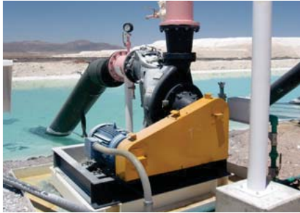
Bomba centrífuga autocebante Gorman-Rupp revestida para bombeo de salmuera.
