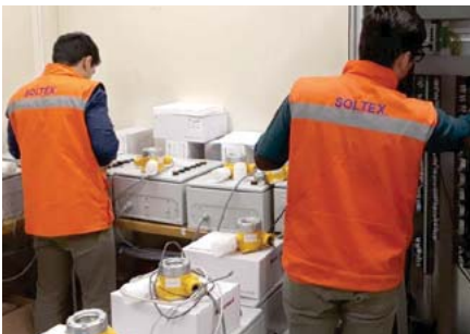
Pruebas de sistema con detectores fijos Honeywell, para monitoreo y detección de gas H_2S , con señales de alarma y autoverificación.
