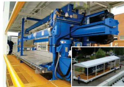
Skids de filtro prensa Durco con válvulas, actuadores e instrumentación.
