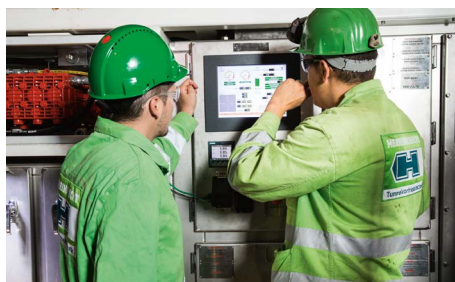
Unidad de fuerza con control por PLC y sistema de almacenamiento de datos.
