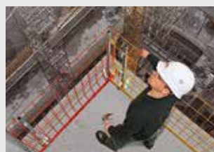
Sistemas de Seguridad
