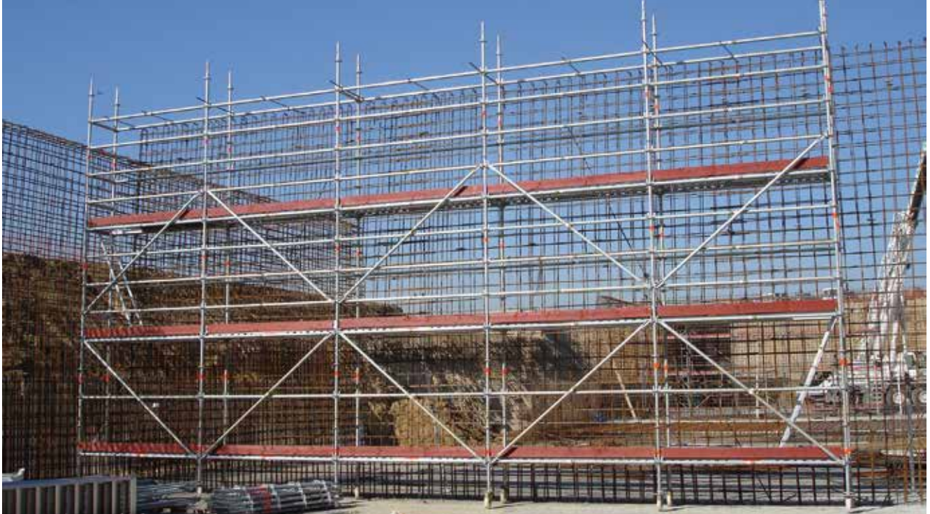
Depuradora en Toledo, España
