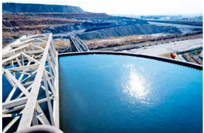
Espesador de alta capacidad para carbón, 20 m de diámetro
