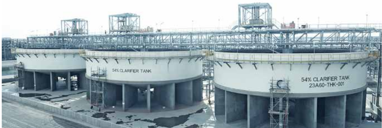
Clarificadores de ácido fosfórico, 30 m de diámetro
