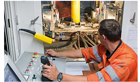
Cabina de control
