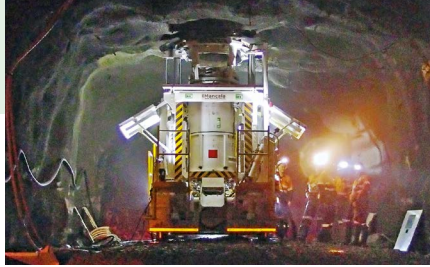
El diseño modular se adapta a galerías con dimensiones reducidas.
