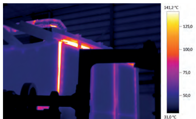
Horno industrial con fallo de aislamiento.
