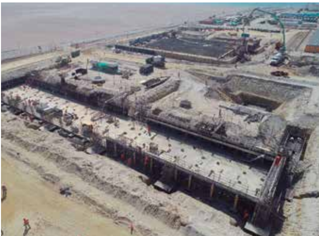
Planta desaladora Mina Spence (Mejillones, Chile)
