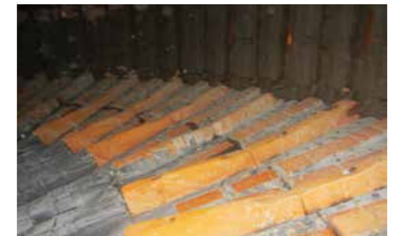
Revestimiento compuesto en tapa de alimentación de molino SAG de \varnothing 10.37 \times 5.19\text{m}
