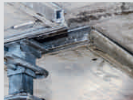
... luego se desmontan las vigas para losa y los paneles. Los puntales con los cabezales de caída permanecen como reapuntalamiento.
