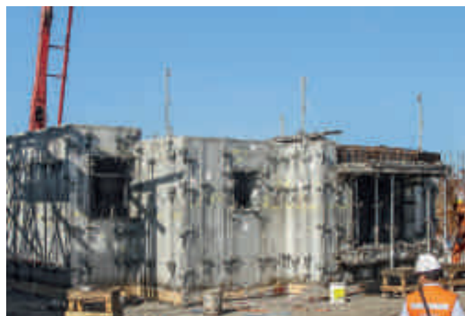
San Andrés del Valle Proyecto de casas en Concepción, Chile 455 casas de 2 pisos Planta baja de 78 m 2 de superficie construida en hormigón
