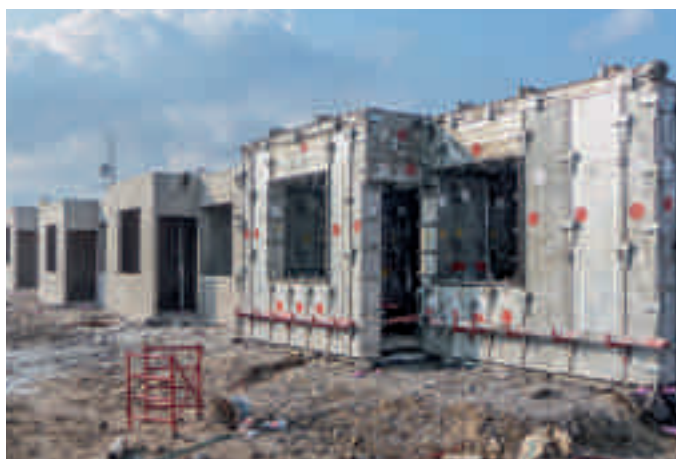
Proyecto de viviendas en Tampico, México 1.500 casas de vivienda de una planta 45 m 2 de superficie por casa, superficies quedan a la vista
