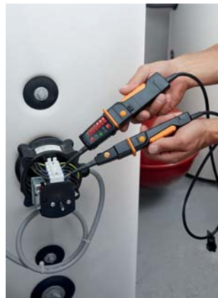
Medición de tensión en un acumulador térmico.
