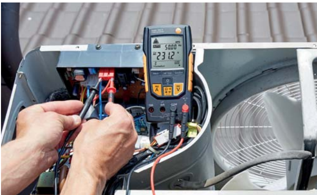
Medición de tensión en un compresor con testo 760 .
