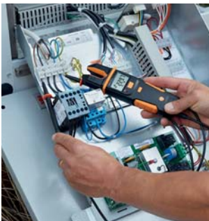
Medición de tensión en un compresor.
