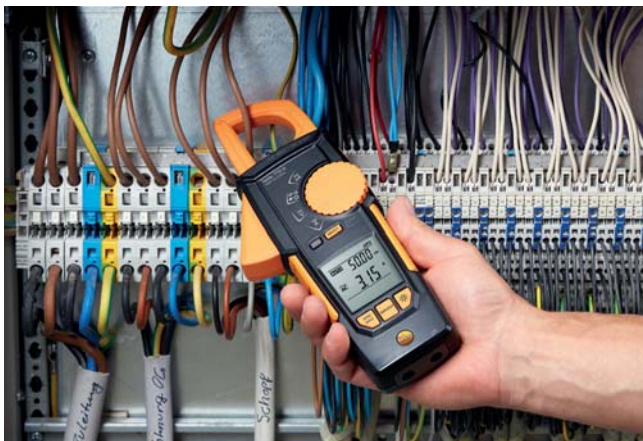
Medición de corriente en el armario de distribución eléctrica.
