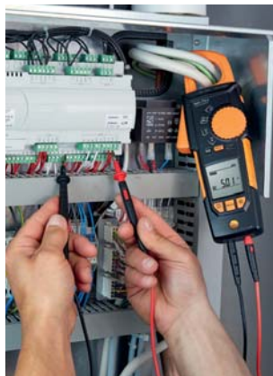
Medición de tensión en el panel de conexiones de una bomba de calor con instrumento de medición colgado.
