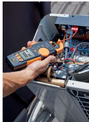
Medición de corriente en un compresor.
