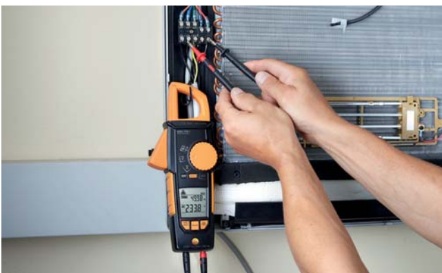
Medición de tensión en un equipo de aire acondicionado con testo 770 .
