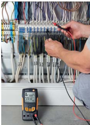
Medición de tensión en armario de distribución eléctrica.
