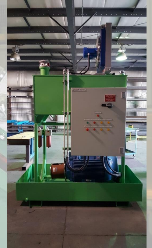
Sitio de HPP específico con refrigerador extra grande, motor de arranque y panel de alarma con bandeja de captura del 110%
