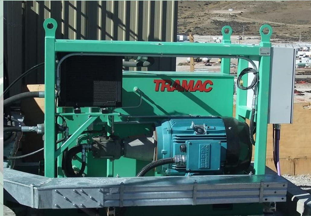
Sitio específico de HPP con bomba hidráulica de flujo variable, enfriador de aceite hidráulico, sistema de arranque suave con panel de alarma y caja de elevación / protección
