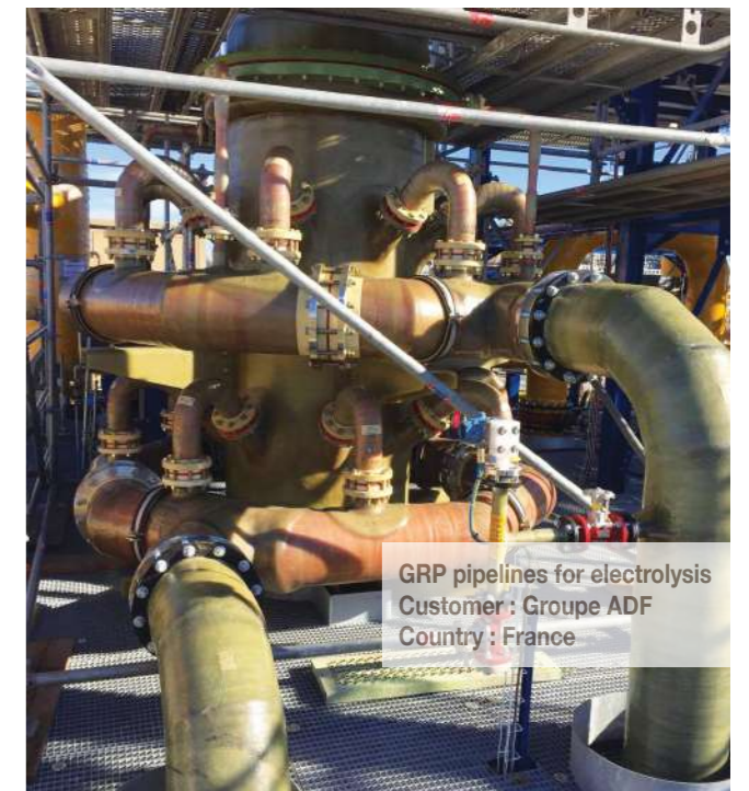
GRP pipelines for electrolysis Customer : Groupe ADF Country : France
