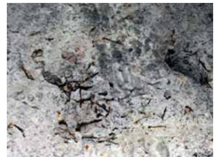
Corrosión in situ del refuerzo de acero
