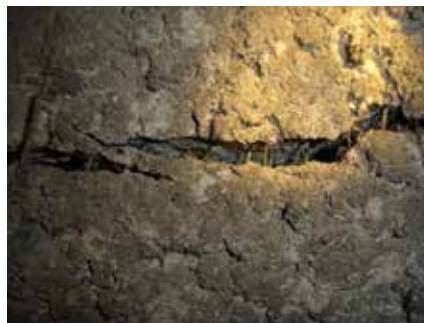
Formación de grietas en Hormigón Proyectado reforzado con fibras
