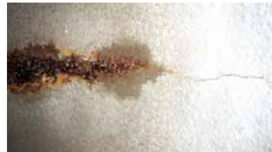
Imagen 1: El agrietamiento en el hormigón conduce a la penetración de materiales corrosivos, dando como resultado una rápida corrosión del refuerzo de acero.
