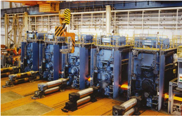
Caja de laminación en un tren de laminación caliente / Roll stand in a hot rolling mill
