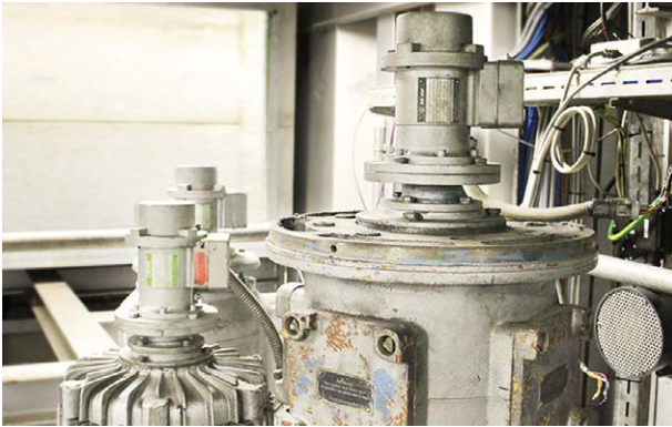
Antes: Tacogeneradores analógicos / Before: Analog tachogenerators
