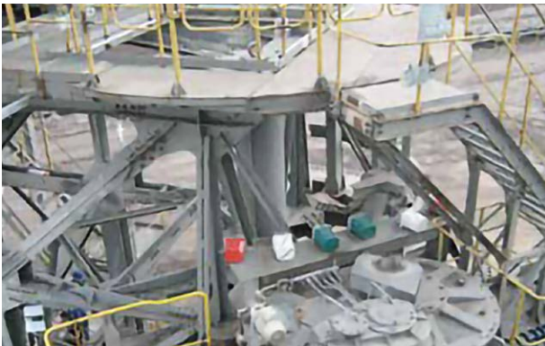
Antes: control de posición con varios CAM switch mecánicos / Before: Position monitoring with several mechanical cam limit switches
