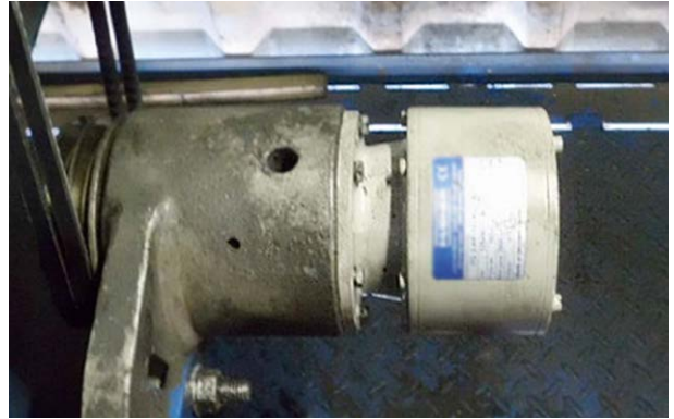
Después: encoder incremental con switch de sobrevelocidad electrónico After: Incremental encoder with electronic overspeed switch
