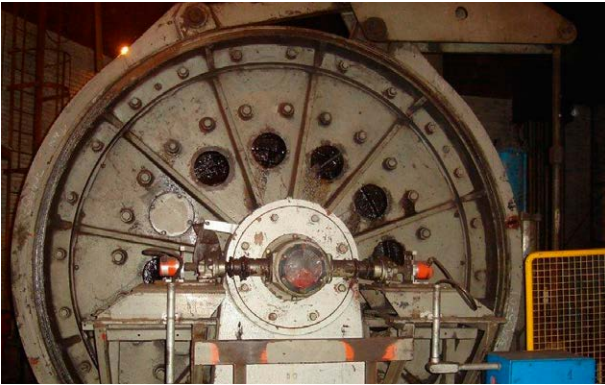
Antes: montaje con caja de transferencia / Before: Mounting via distribution gear
