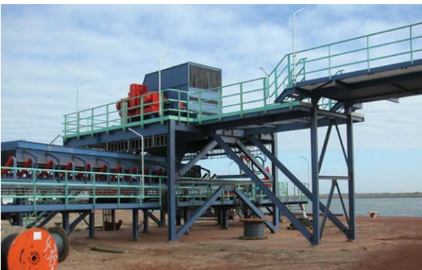
Estación de cintas transportadoras a cielo abierto. / Conveyor drive station in open cast mining
