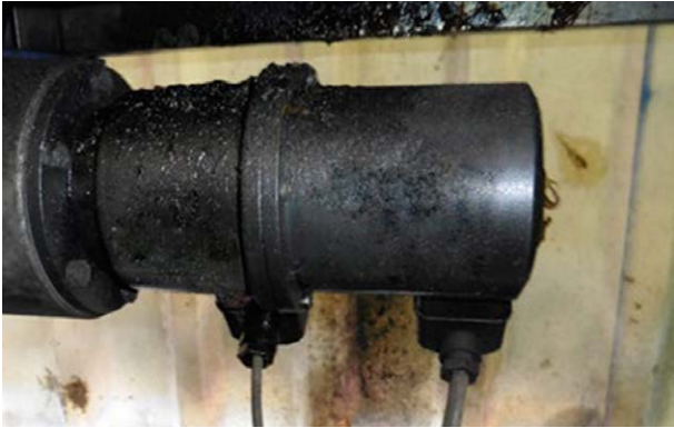
Antes: tacómetro con switch de sobrevelocidad mecánico Before: Tacho with mechanical overspeed switch
