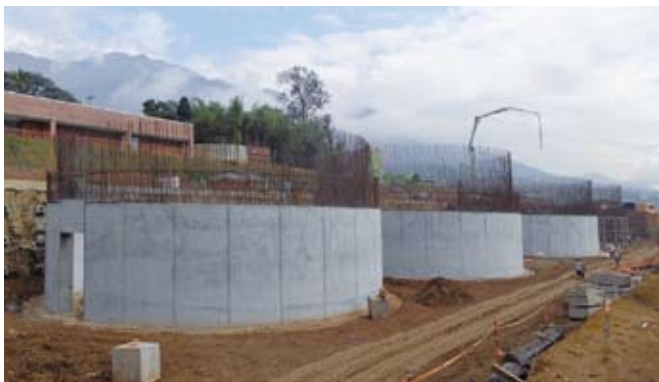
Planta Tratamiento de Aguas Bello (Medellín - Colombia)
