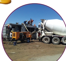
Bombeo a Distancia
