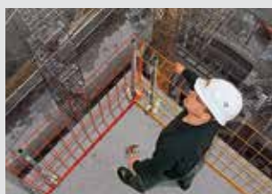
Sistemas de Seguridad
