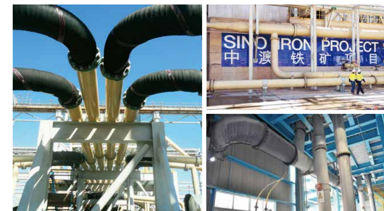
Tubos de acero revestidos en goma utilizados en el sitio
