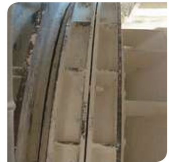
Junta de entrada del horno rotativo
