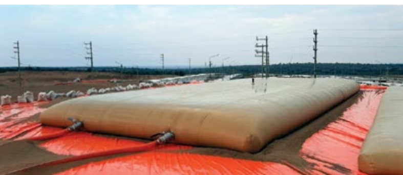
■ Estacionario 80 000 Lts. INGENIUM INGENIERÍA Y CONSTRUCCIÓN Agua potable
