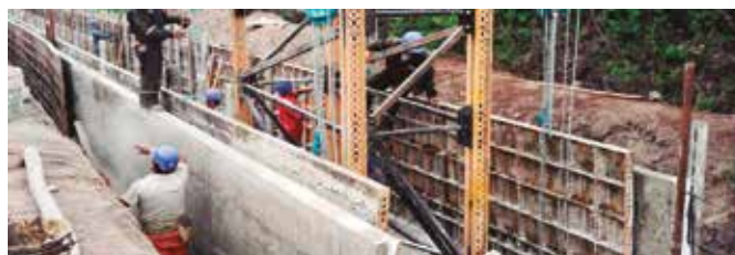
COMAIN en muro de galerías
