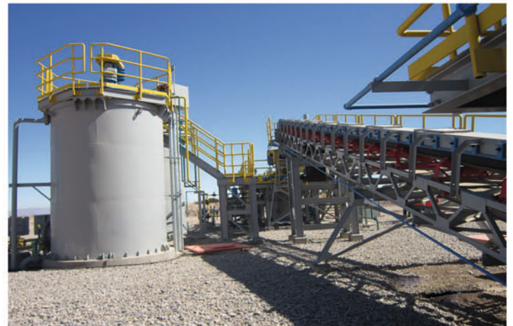
Planta completa para la obtencion y el procesamiento de lechada de cal
