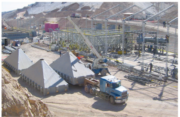
Equipos ristalizadores y Tanques de proceso
