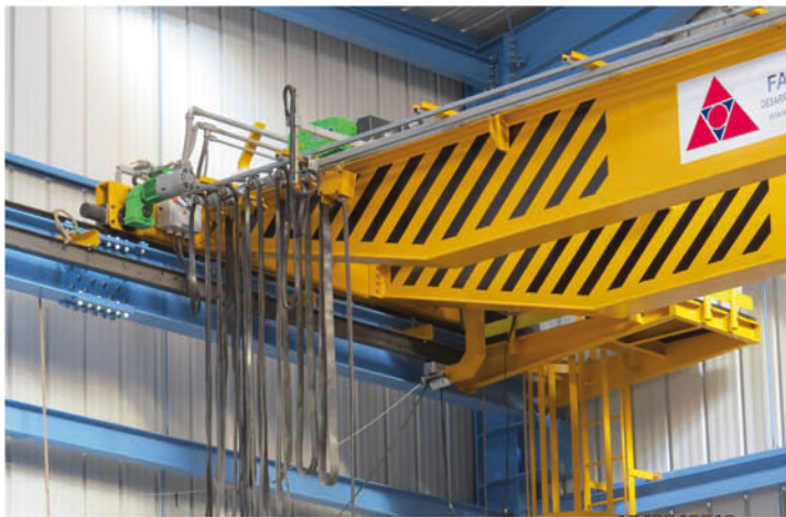
Naves industriales con puentes grúa para almacenamiento y despacho de materiales
