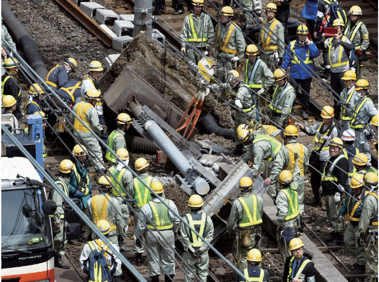
JR山手線の神田—秋葉原線路内で架線支柱が倒れた = 4月12日 東京都千代田区
