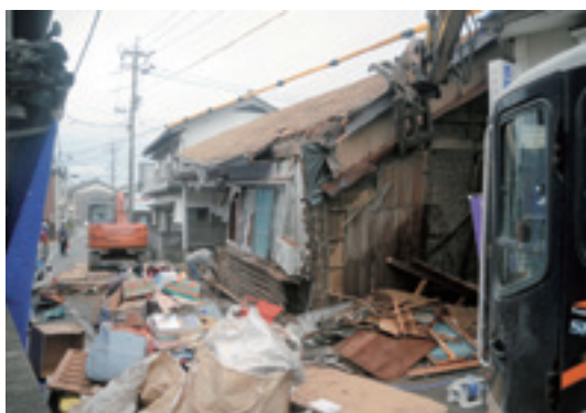
地震から6日後に全壊して1階部分がつぶれ、道路をふさいだ空き家（鳥取県北栄町／山陰中央新報社提供）
