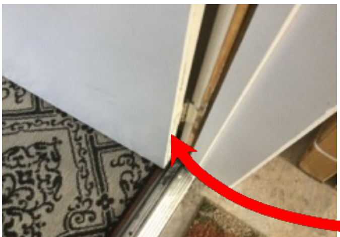
Garage Passage Door Bottom door hinge loose
